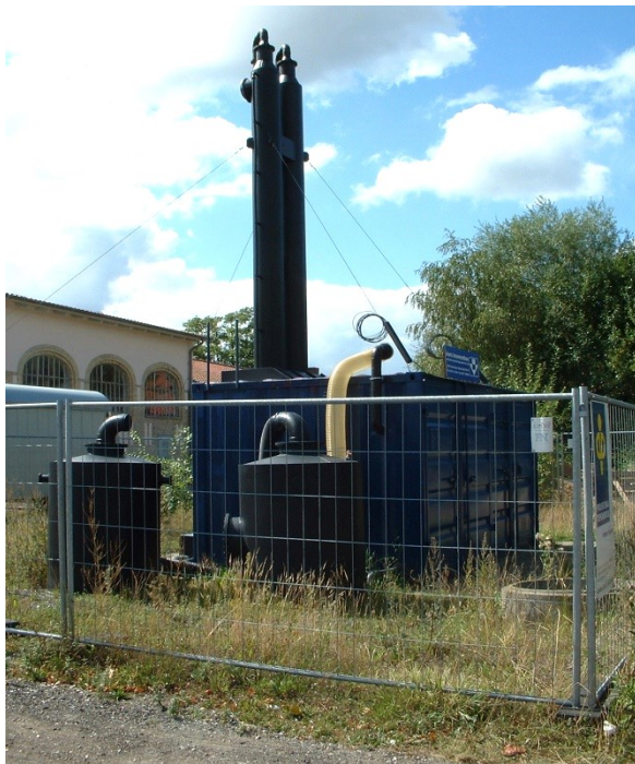
Anlage zur Reinigung des verunreinigten Grundwassers im Bereich einer ehemaligen chemischen Reinigung
