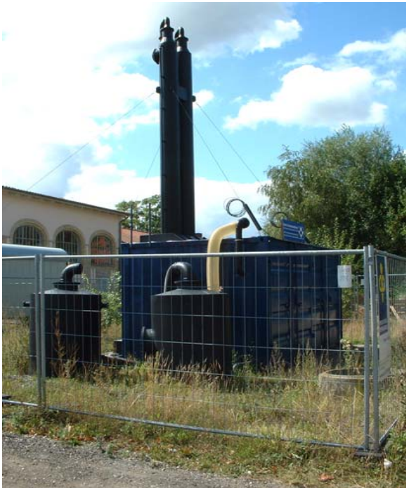
Anlage zur Reinigung des verunreinigten Grundwassers im Bereich einer ehemaligen chemischen Reinigung
